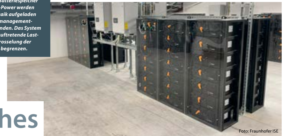
Foto: Fraunhofer ISE
